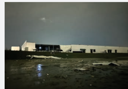
Daños por tormenta en el edificio Piston
